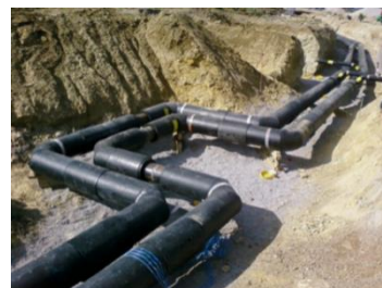
Figure n°3. Conduite de transport d'eau chaude
