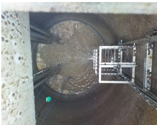
Figure 2 - PR Village - Saint-Drézéry - cuve avec panier dégrilleur
