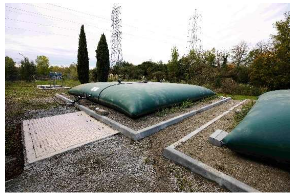
Bâches de stockage
